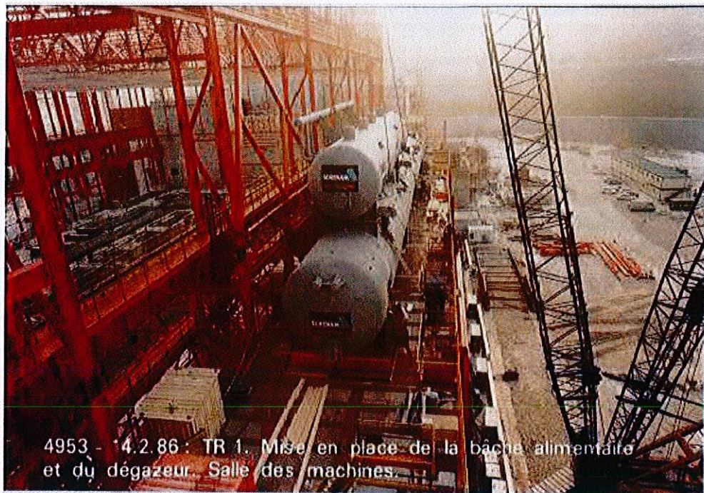
Bâche alimentaire et son dégazeur
