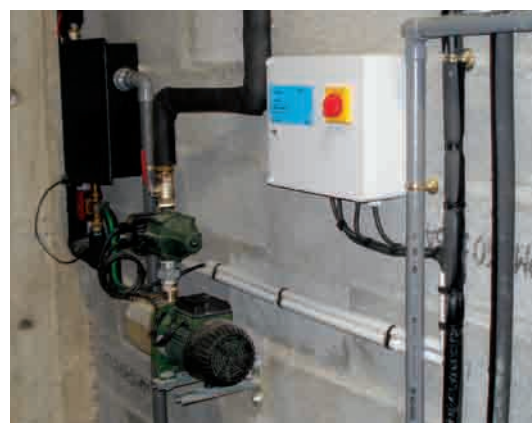
6 L'ensemble hydraulique (pompe, commande de pompe, vanne 3 voies)
