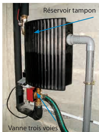
5 La vanne 3 voies et le réservoir
