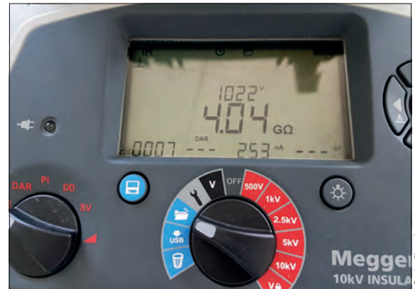
6 Résultat de mesure d'un transformateur sain
