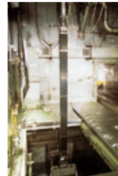
Dépose d'un élément combustible en panier d'entreposage.
