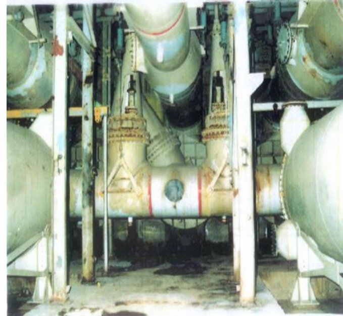
Zone tuyauteries de G2
