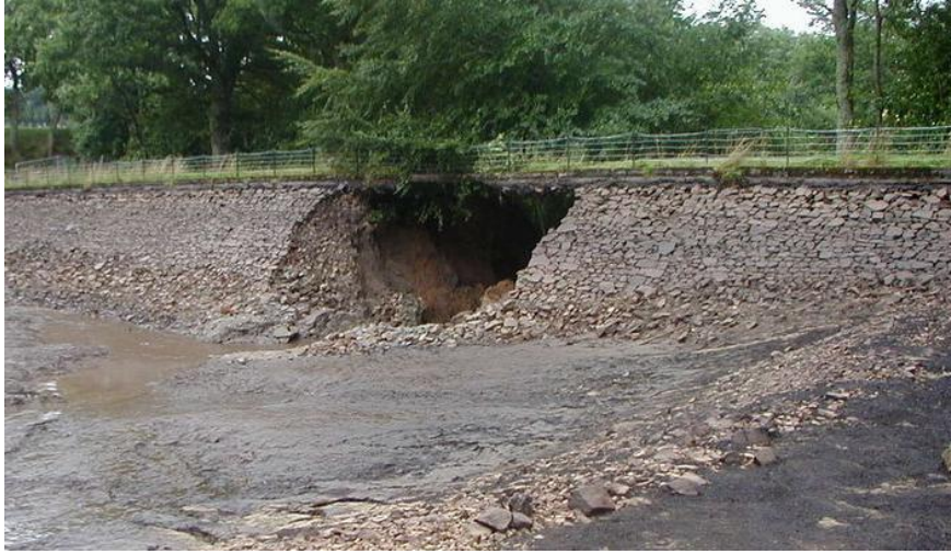
Figure 12 : Le 15 juillet 2001 au matin l'étang des Ouches se vide par une brèche ouverte dans le barrage des Ouches, suivant une section où passe la conduite de vidange. Ce barrage âgé de plus de deux siècles, avait été répertorié sur la première carte topographique du royaume de France, dite Carte de l'Académie ou Carte de Cassini, du nom des astronomes qui se sont succédés à la dresser au XVIII e siècle [5]
