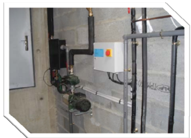
Local avec pompe et vanne
