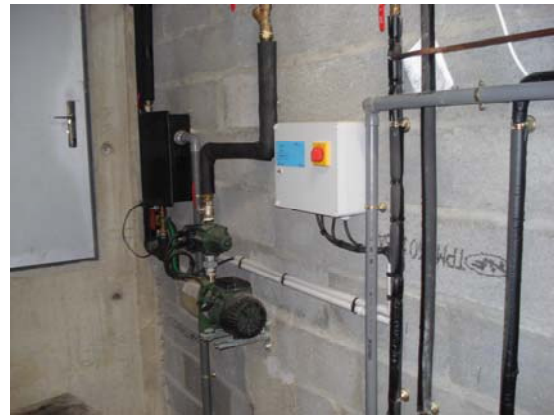
Ensemble hydraulique (pompe, commande de pompe, vanne 3 voies)
