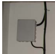
Boîte de raccordement panneaux photovoltaïques
