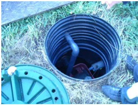
Cuve de 7500 l : Vue de dessus
