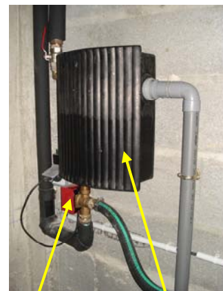
Vanne 3 voies et réservoir
