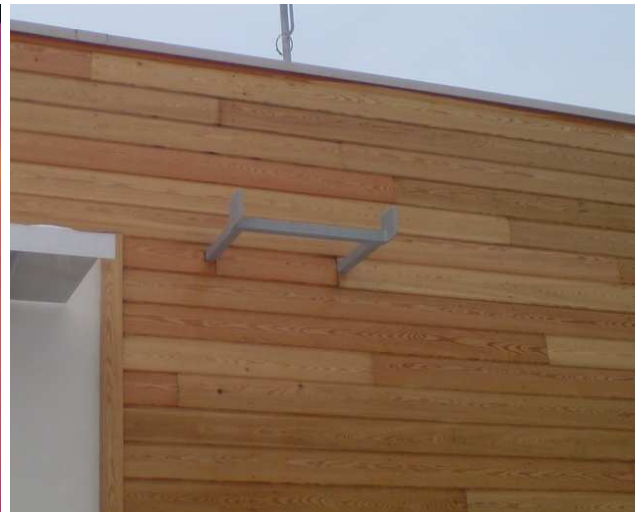
Figure 16 : Photo du support de fixation de l'échelle
