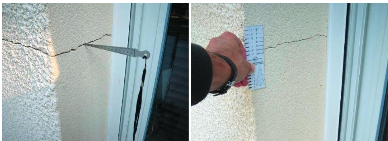
Figure 17 : Une même fissure, ouverte de 2 mm en fin d'été et de 0,5 mm en fin d'hiver, source [21]
