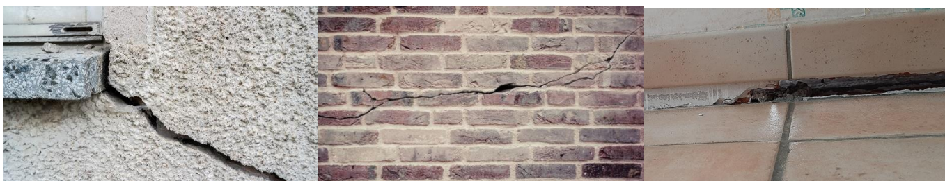
Figure 1 : Exemples de dégâts dus aux retraits ou gonflements des argiles, sources [17,18,19]
