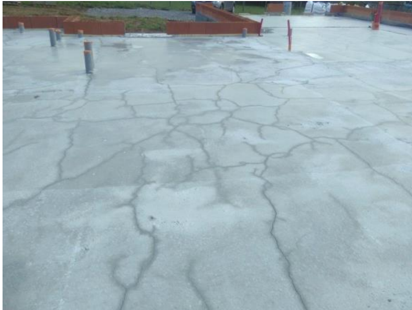
Figure 1 : Fissuration d'une dalle en béton à cause d'un retrait de dessiccation [3]
