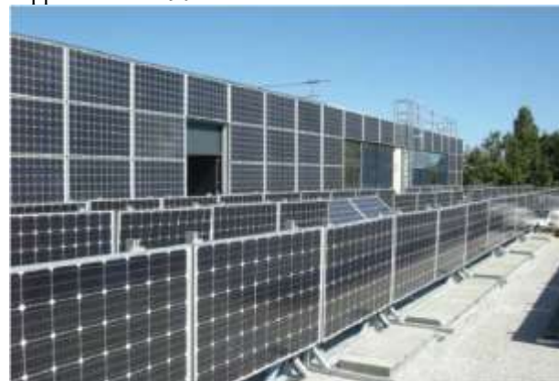
Figure 4: Terrasse expérimentale de 35 kWc, située au R+1 du bâtiment ADREAM
