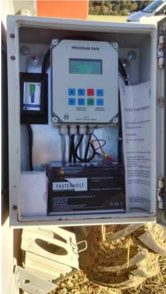
Photo 2 : La partie commande existante gérant les différentes recettes d'irrigation
