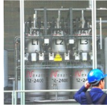
Figure 4.: Limiteur supraconducteur de 40 MVA dans une sous station d'Essen (Allemagne).
