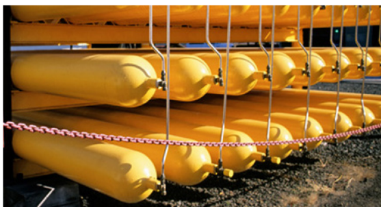
Figure 36 : Stockage de l'hydrogène comprimé haute pression dans bouteilles de 300 L
