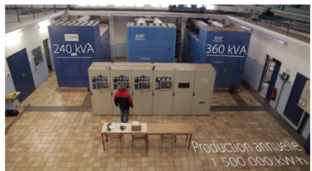
Figure 35 : Les groupes électrogènes en service sur Sein
