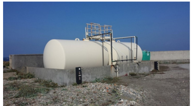
Figure 34 : La citerne de stockage de fioul
