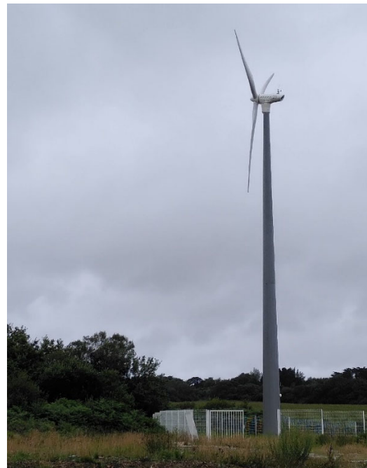
Figure 19 : éolienne Viking VS25 du « smart grid »
