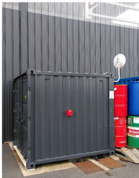
Figure 11 : petit container extérieur au bâtiment ENR2 contenant l'onduleur PV et le coffret « SolvéoBox ». On remarque les passages de câbles aménagés au sol pour relier les différents tableaux/bâtiments (ENR1 et ENR2 et ENR3)
