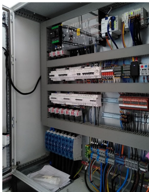
Figure 10 : coffret « Solveobox » pour raccordement réseau et mesures/datalogger de supervision pour l'éolienne, les champs PV, le stockage et les récepteurs de ENR2 mais aussi de ENR1 et ENR3. S'y trouvent le jeu de barres de raccordement, un automate et des E/S Wago, les organes de commande et protections ainsi que les borniers.
