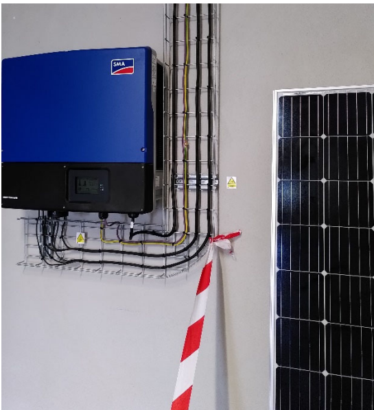
Figure 13 : onduleur PV SMA type « Sunny tripower » (capable de fournir de la puissance réactive sur demande) et vue sur un module PV du type de ceux implantés en toiture.
