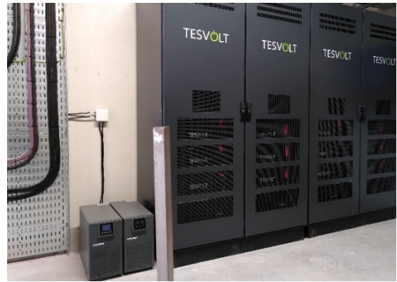
Figure 14 : les deux coffrets de 67kWh chacun contenant les unités de stockage (TESVOLT type « TSHV70 » / 14 batteries de stockage avec cellules « Lithium NMC prismatic Samsung SDI » et équilibrage actif)
