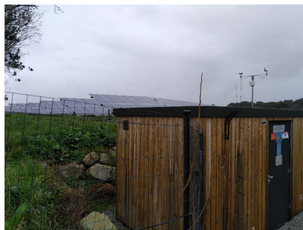
Figure 26 : poste HTA de livraison au réseau de distribution public Enedis (Sn=2MVA), ZA de Kerdanvez
