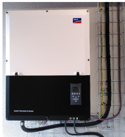
Figure 15 : chargeur de batterie SMA type « Sunny tripower storage 60 » associé aux batteries TESVOLT.
