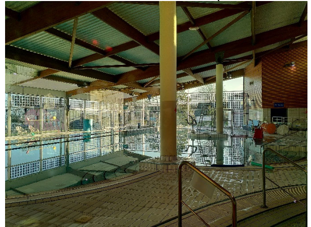
Figure 3 : vue des vitrages avec cellules PV intégrées depuis l'intérieur de la piscine « Nautil'Ys » (déc. 2021)
