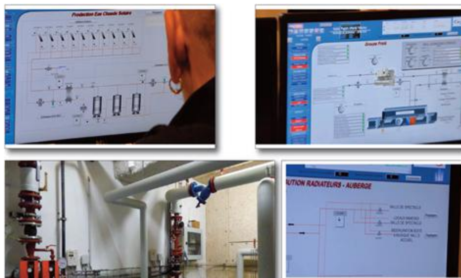
Figure 2 : Vue des écrans d'exploitation (GTB CVC ECS ...) et d'une partie de l'installation thermique de la halle (visite technique TP Line du 22/11/18)
