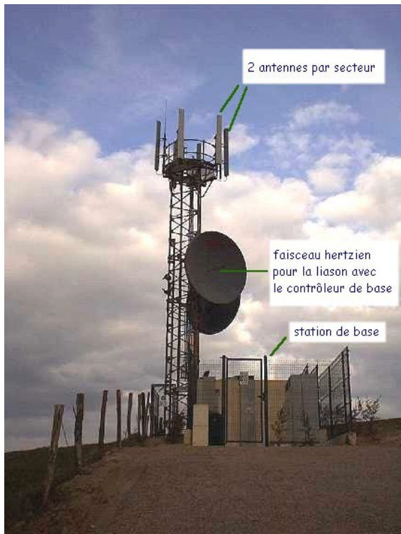
Figure 4 : La station de base du réseau GSM.
