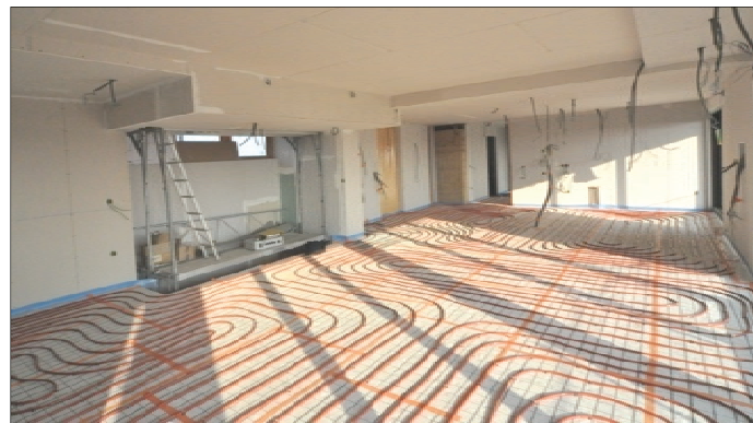
Figure 6 : plancher chauffant de l'Observatoire
