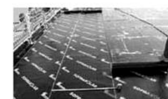
Pose 1 ère couche d'étanchéité, le Soprasolar® Base (lès de 10 m x 1 m). Mise hors d'eau réalisée.
