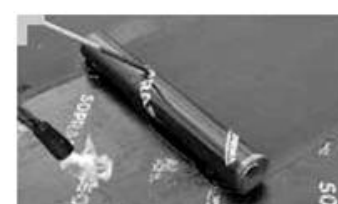
Pose de la 2 ème couche d'étanchéité, le Soprasolar® Cap (lès de 6 m x 1 m). Pose à joint décalé de 25 cm.
