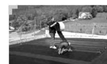
Collage de la cellule, puis mise en place d'un cordon Soprasolar 200 en tête de cellule.
