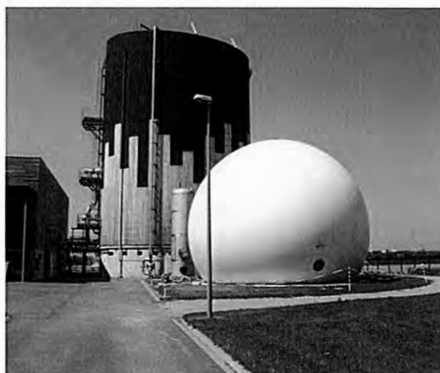
Digesteur et gazomètre - Source: OCTEVA
