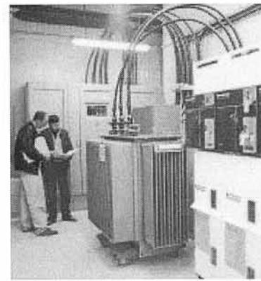
800 kVA - 20 kV / 400 V
