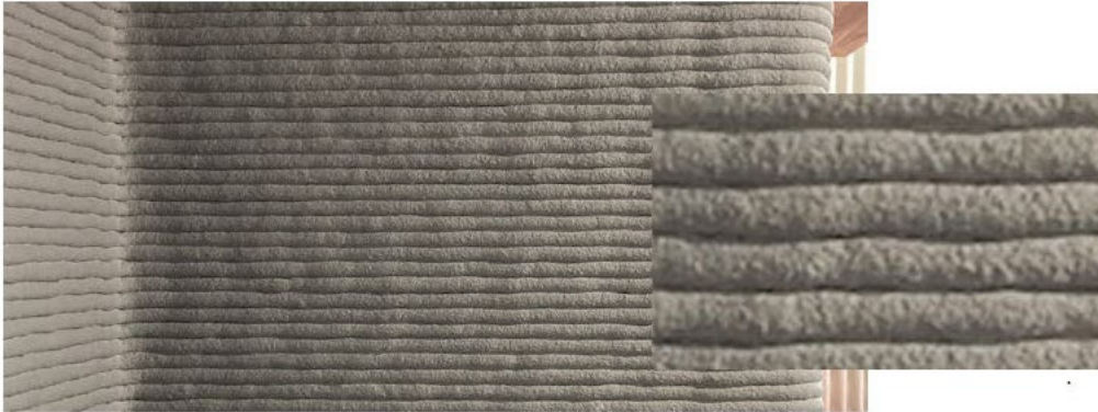
Figure 15 : motif de vibration après un angle droit sur un mur
