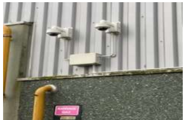
Vidéoprotection du parking
