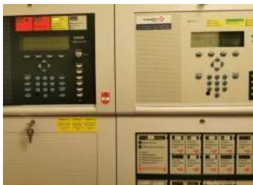
Centrale incendie (PC sécurité)
