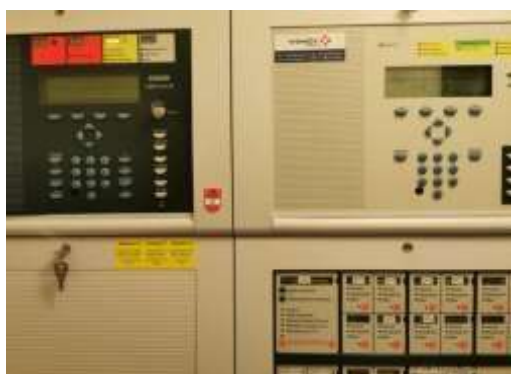
Centrale incendie (PC sécurité)
