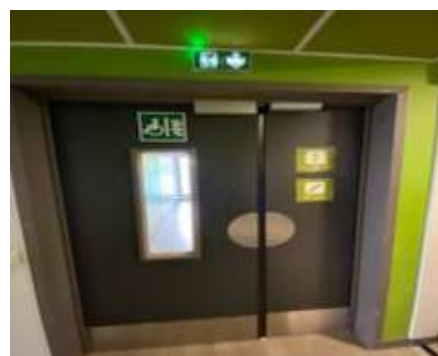
Porte coupe-feu et éclairage de sécurité
