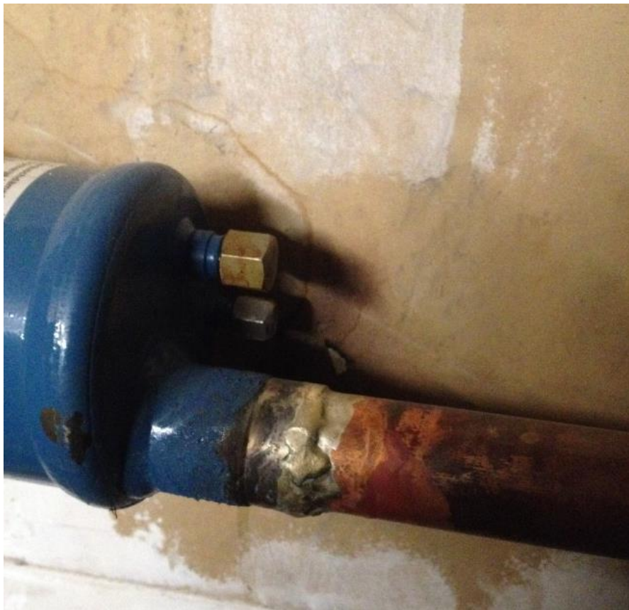
FIGURE 21. EXEMPLE DE SOUDURE MAL REALISEE
