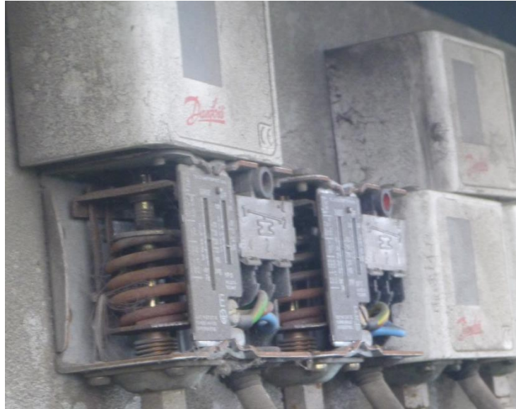
FIGURE 20. PRESSOSTAT SANS BOITE DE PROTECTION, SOUFFLET DE PRESSOSTAT EN MAUVAIS ETAT
