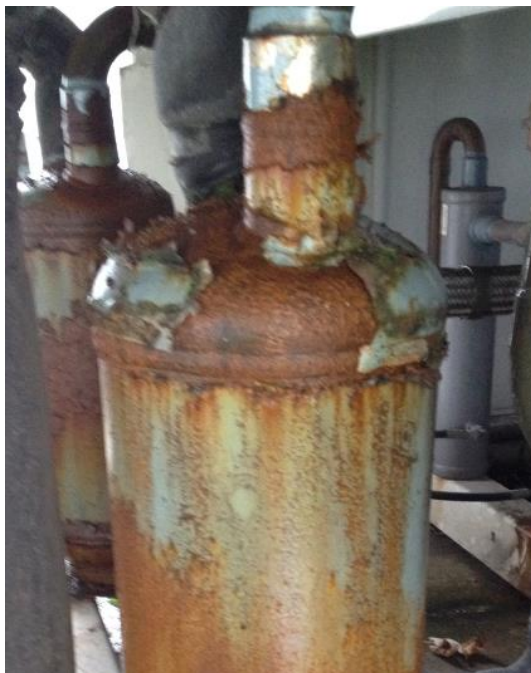
FIGURE 17. EXEMPLE DE CORROSION AVANCEE SUR UN RESERVOIR D'ASPIRATION SITUE EN EXTERIEUR
