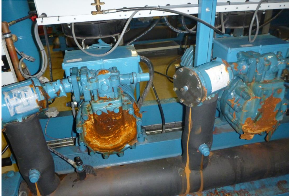
FIGURE 18. EXEMPLE DE FLASQUE COMPRESSEUR TRES CORRODEE
