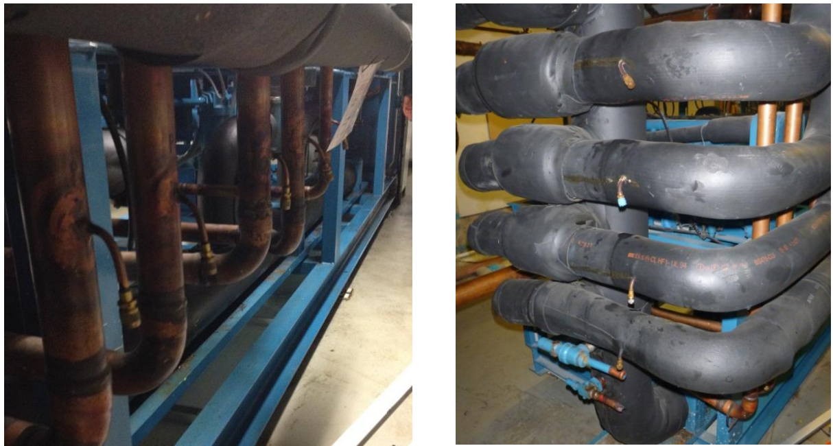
FIGURE 16 : EXEMPLE DE CENTRALE DE COMPRESSION COMPRENANT DE NOMBREUSES PRISES DE PRESSION
