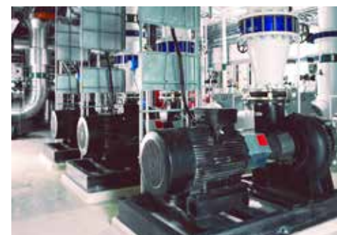
↑ Installation de pompes normalisées NK dans une usine de produits pharmaceutiques.
