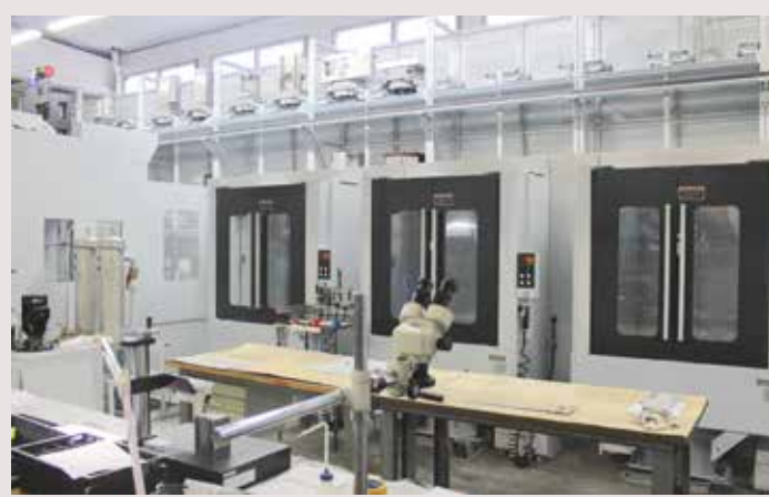
↑ La cellule flexible installée chez J. C. Bouy permet de réduire les temps de cycle.
