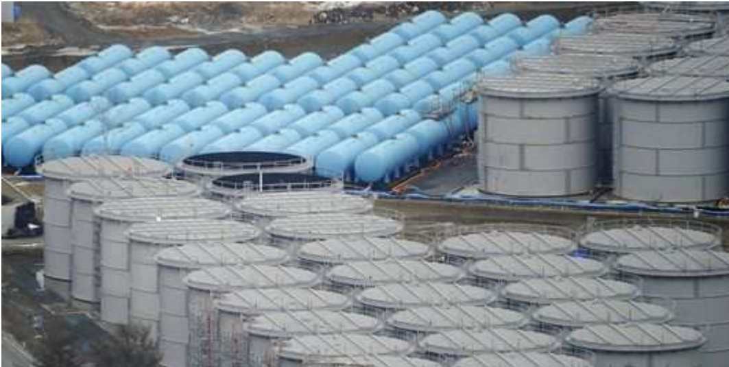
Des citernes ont été installées par Tepco sur le site de Fukushima pour stocker l'eau contaminée suite à la catastrophe nucléaire. | Kyodo News/AP
