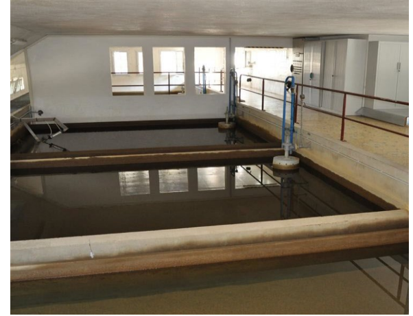
Bassins de filtration à la station d'Autun
