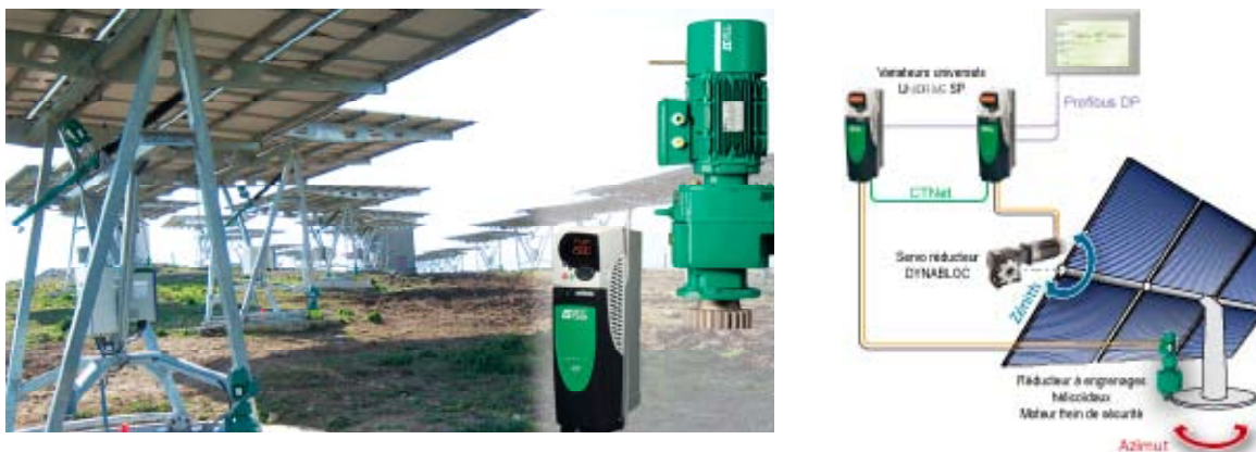
Figure 148 Maximisation de la production d'une centrale photovoltaïque (Document Leroy-Somer)
