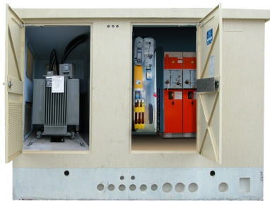
Image 14 Poste de transformation HTA/BT
