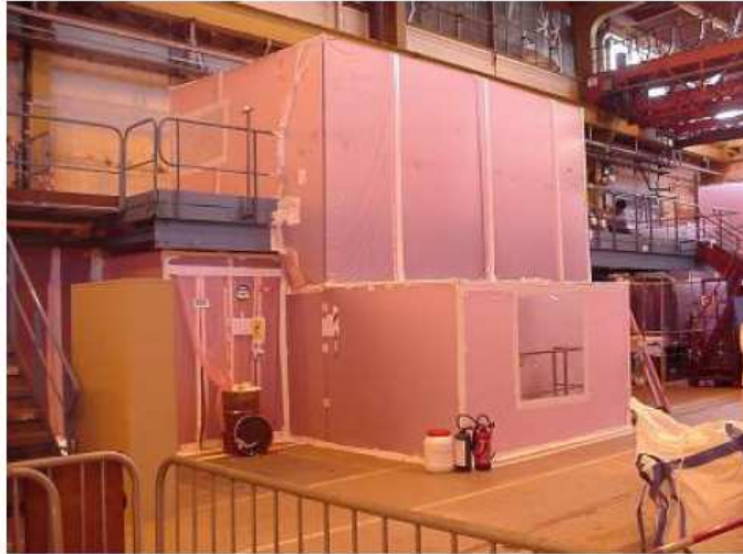
Exemple de sas vinyle: Installation G1, Marcoule
